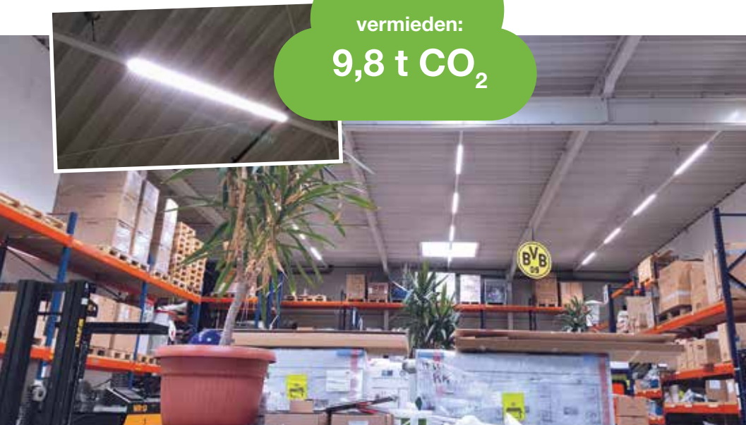
Sparen mit LED-Lampen: Unser Lager und die Fahrzeughalle haben wir umgestellt. Der Energieverbrauch und die Kosten werden dadurch um drei Viertel verringert.
