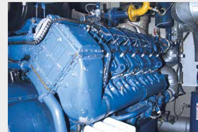
Blockheizkraftwerk 1 in der Gartenvorstadt
