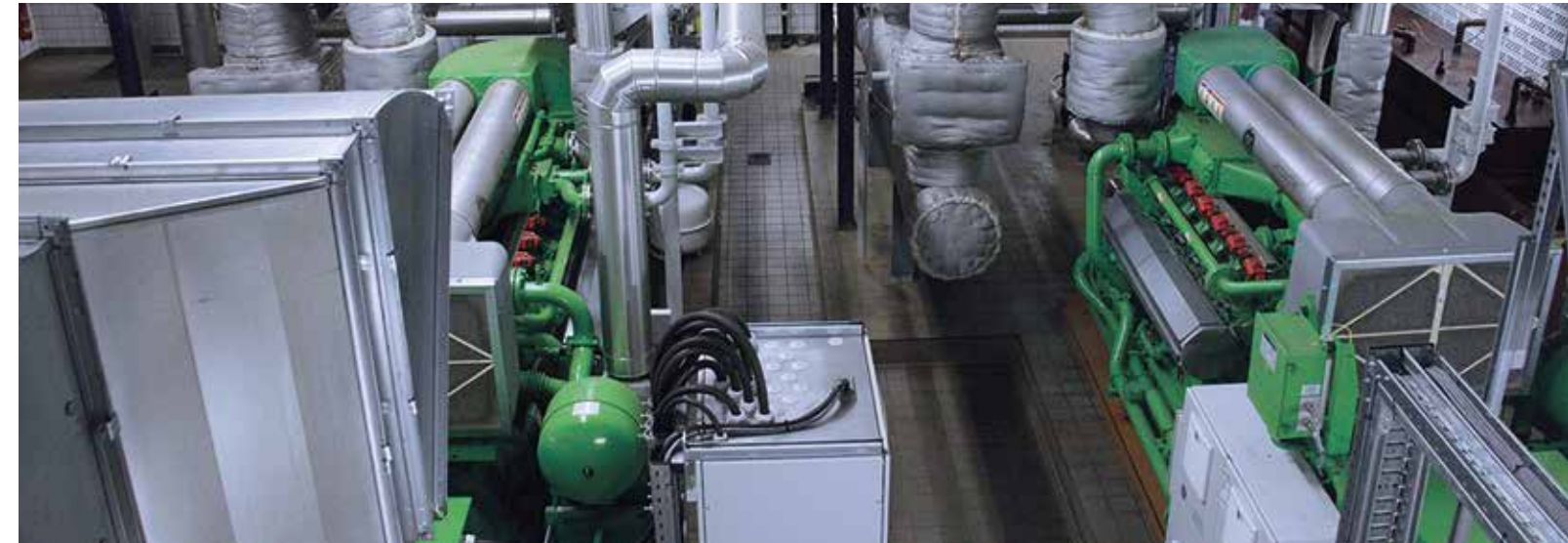
Die Modernisierung des BHKW II macht sich für die Kunden und für das Klima bezahlt. Die Motoren punkten mit verbesserten Wirkungsgraden.
