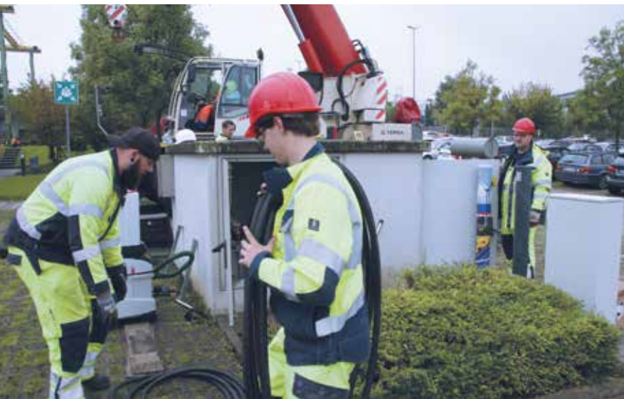
Netzverstärkung für Elektromobilität auf unserem Firmengelände: Die Versorgung der zusätzlichen E-Tankstellen forderte eine Leistungserhöhung in der 10 kV-Station.
