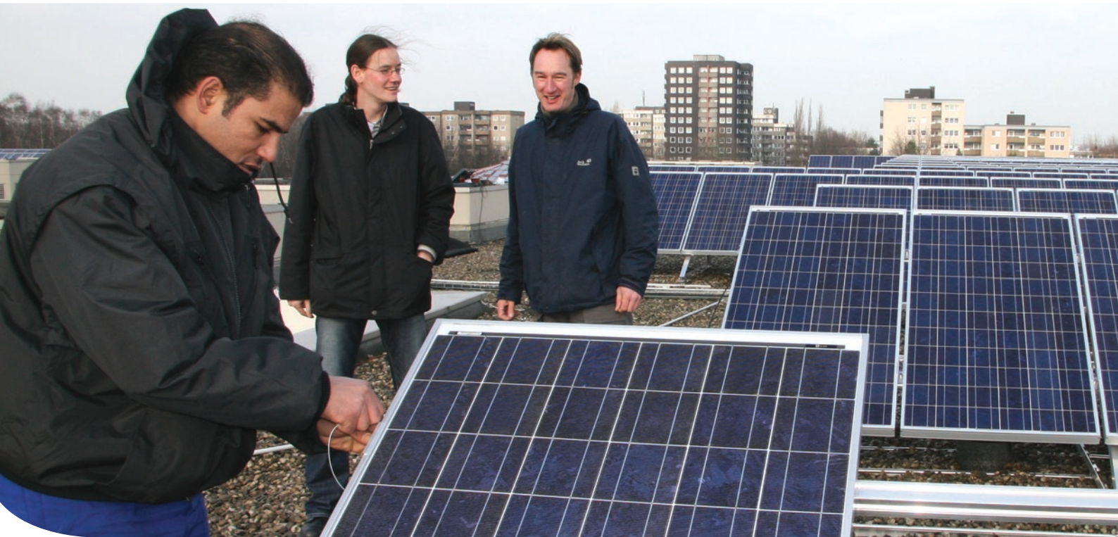
Ein Schulzentrum als Solarstrom-Farm: Mit dem Bürgerfonds UN-Solar I fördern die Stadtwerke Unna die Nutzung regenerativer Energien.
