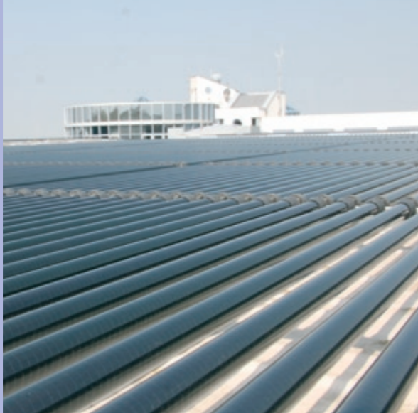
Photovoltaik-Anlage auf dem Lagergebäude der Stadtwerke. ↑
