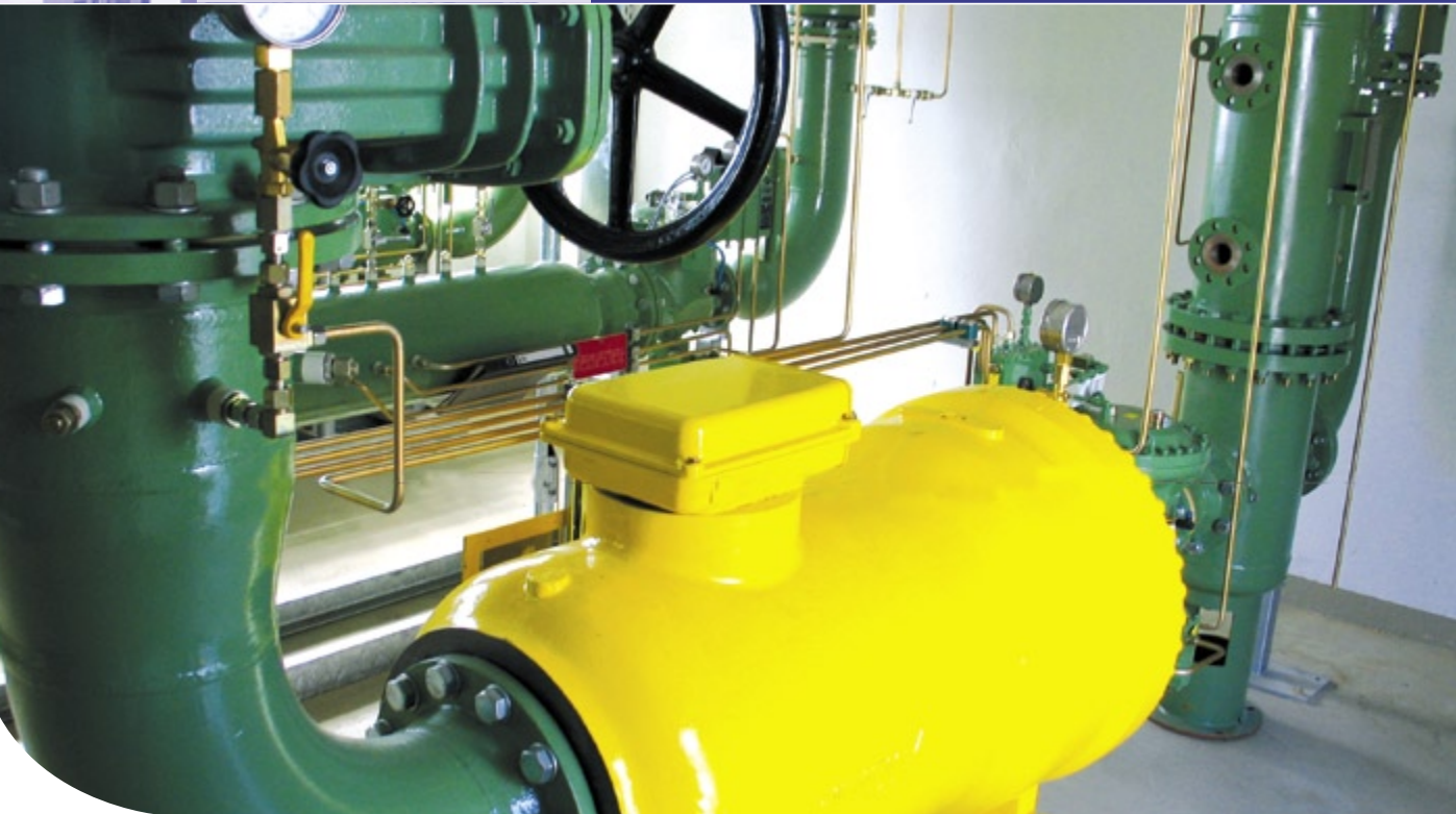
Entspannungsturbine in der Gasübergabestation Zechenstraße, Nennleistung 75 kW elektrisch.
