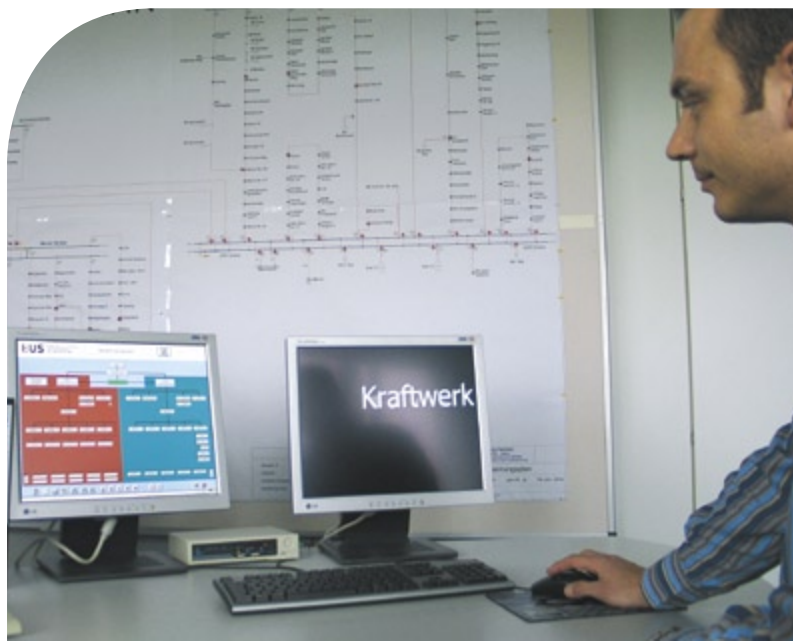
Leitwarte der Stadtwerke Unna mit Steuerstand und virtuellem Kraftwerk.
